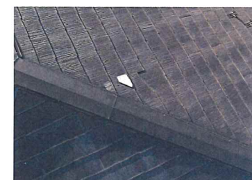
スレート瓦の一部が破損しています
