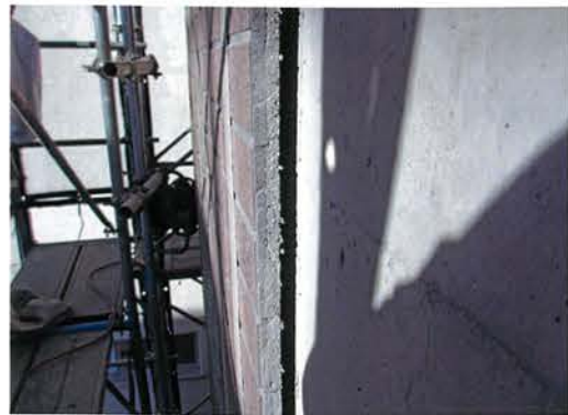
建物本体のコンクリートからタイルが剥離!
