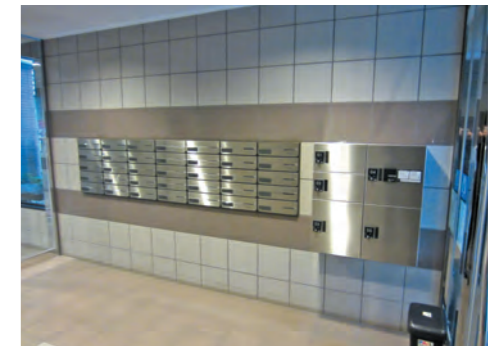
カードキー対応のメールボックス・宅配ボックス
